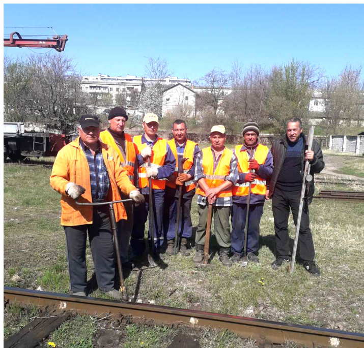
Montatorii de linii ai districtului nr. 10, condus de brigadierul O. Baxan, execută lucrări de rectificarea ecartamentului la stația Ungheni
